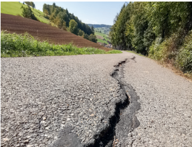
Belagschäden an der Ranspelstrasse.
